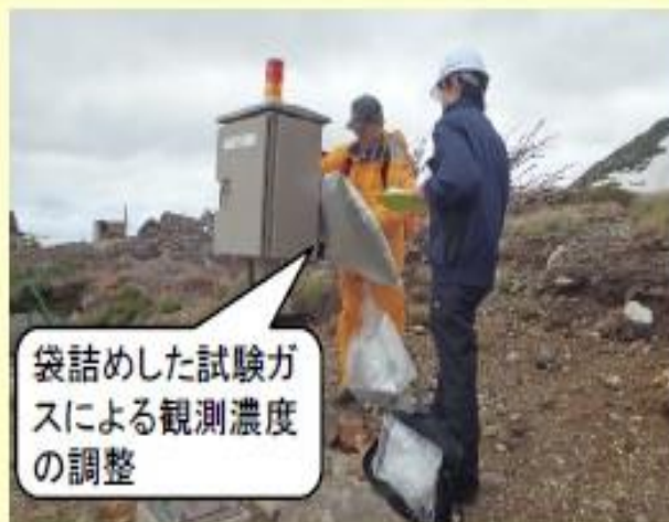
火山ガス濃度の点検
