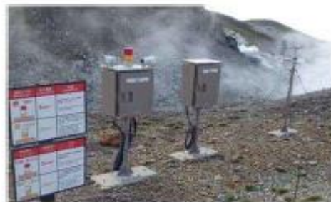
火山ガス観測施設
